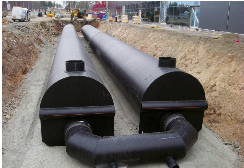
Specialtillverkad måttanpassad dagvattentank i Växjö som jämnar ut belastningsvariationerna i närområdets dagvattensystem. Volym 1000 m 3 .
