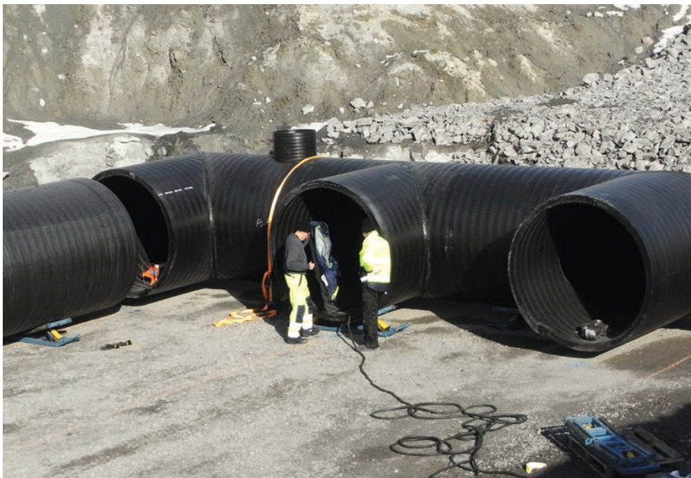
Dagvattenmagasin i Umeå på 700 m 3 .
